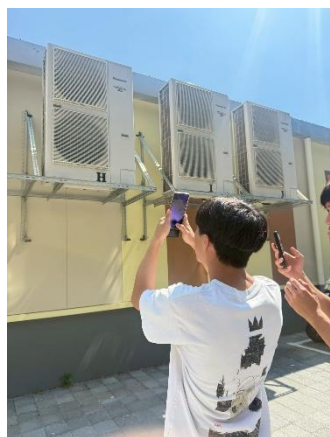
熱顯像儀操作之空調排熱量測 1
